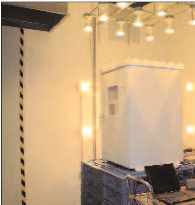
Estación de Prueba de carga Solar
